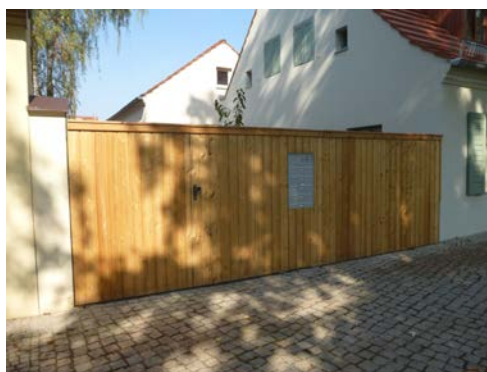
Briefkastenanlage, im Holzzaun integriert
