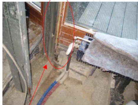
Wohnungstrennwände wurden zum Teil im Bereich der Außenwand an die Holzkonstruktion der Fensterfront angeschlossen. Dieser Anschluss entspricht nicht der geforderten Bauart für Wohnungstrennwände mit einem Feuerwiderstand von F90
