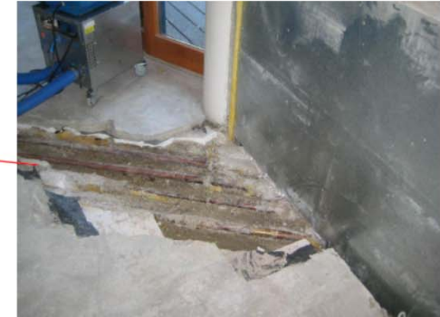
gebündelte Leitungsdurchführung durch Brandwand
