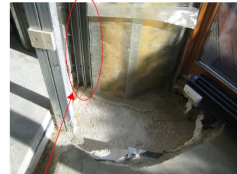
Anschluss der Doppelständer zu Vormauerschale z.T. mit breiter offener Fuge, keine durchgehende Dampfsperre
