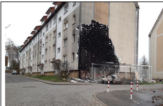
Gefährliche Silvesterknallerei: An der Ecke Ulrich-Steinhauer-Strasse fing eine Hausfassade Feuer. Zum Glück ist nicht noch mehr passiert.
