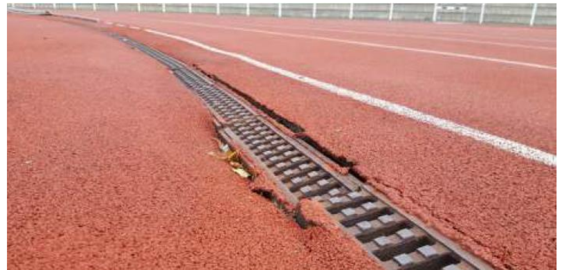
Beschädigte Entwässerungsrinne innen
