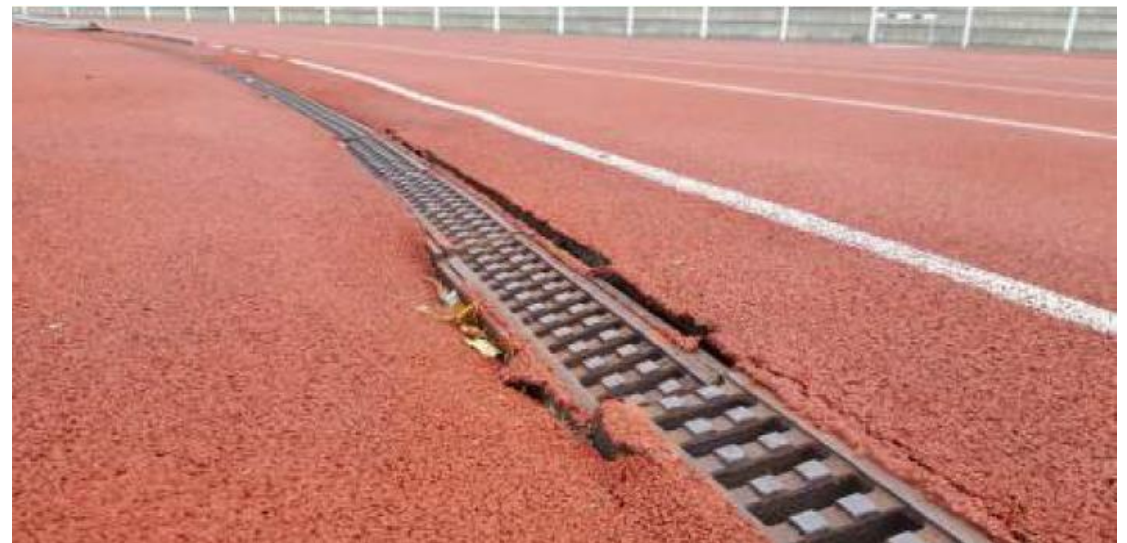
Beschädigte Entwässerungsrinne innen
