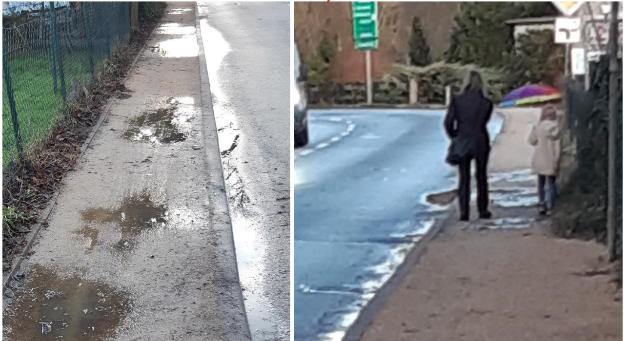
Der frisch befestigte Weg. Gerade hatte es geregnet, nicht einmal allzu kräftig: Sofort standen Pfützen auf dem Gehweg. Für Fußgänger stellte sich die Frage: Augen zu und durch oder auf die Fahrbahn ausweichen? Die Probleme sind Thema meiner nächsten Straßeninspektion mit dem Tiefbauamt.
