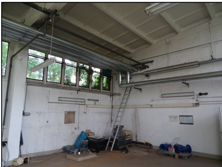
Abbildung 13: Innenbereich des Heizhauses
