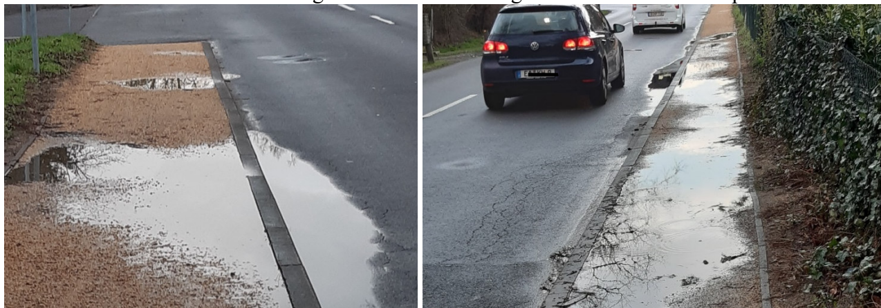
Klassischer Fall von Verschlimmbesserung: Der B 2-Gehweg ist neu gemacht worden, aber wer ihn nach einem Regenguss nutzen muss, hat die Wahl, durch Pfützen zu waten oder auf die Fahrbahn auszuweichen.
