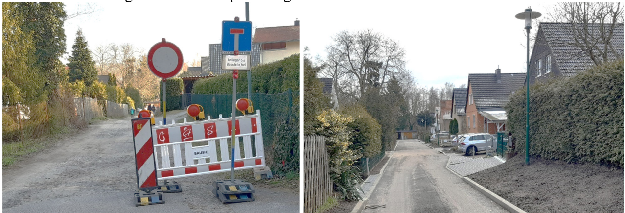
Das Foto links habe ich im März 2022 aufgenommen: die Bauarbeiten hatten gerade begonnen. Das Foto rechts genau ein Jahr später, im März 2023: die Straße Alter Weinberg ist gerade fertig geworden.
