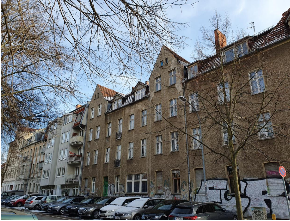
Abbildung 26: unsanierte, schadhafte Fassade
