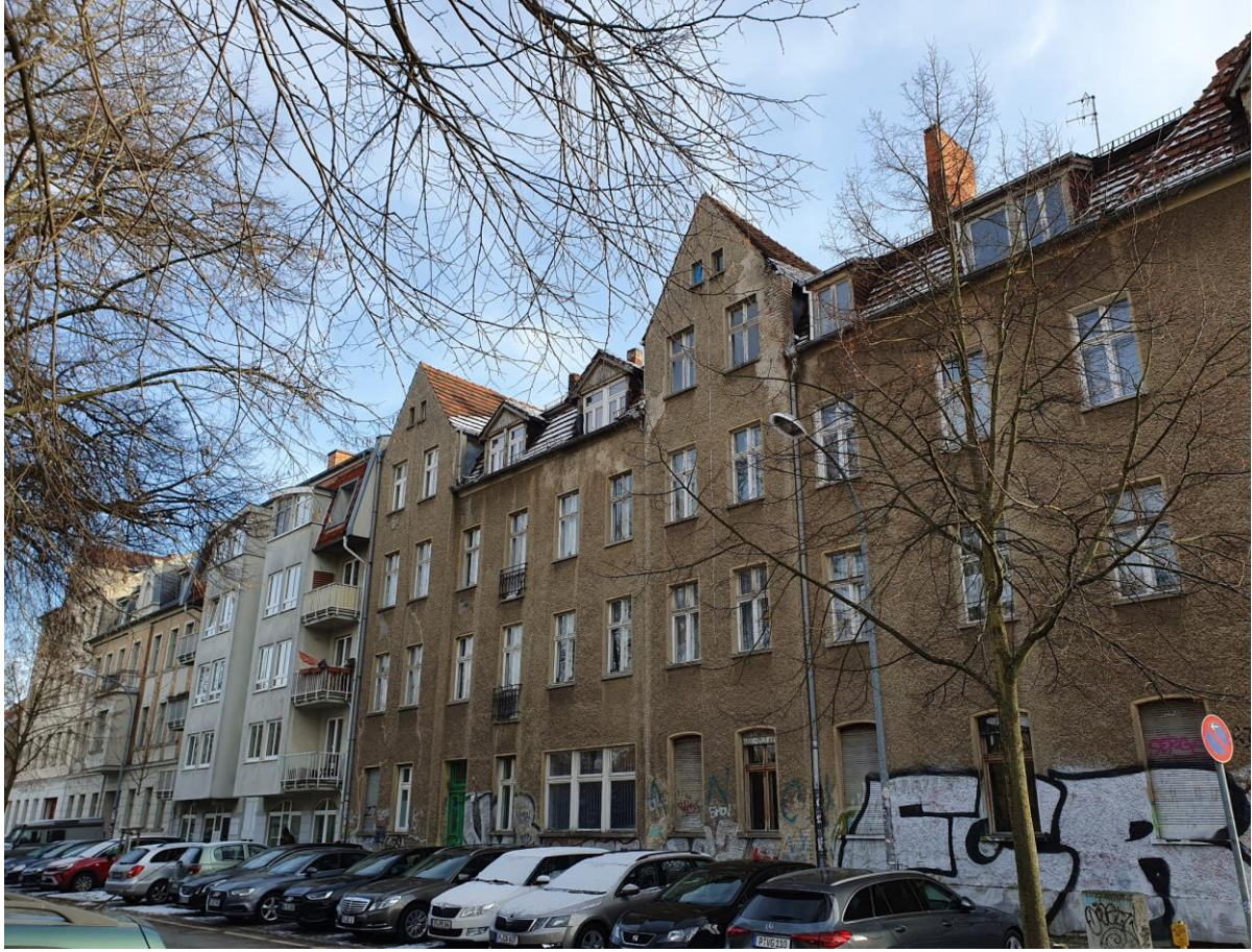
Abbildung 26: unsanierte, schadhafte Fassade
