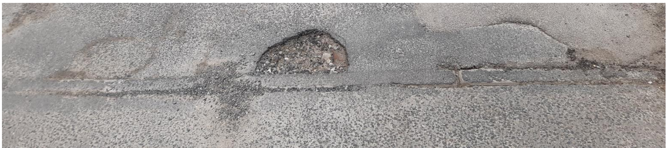
Am Ende des Winters: Reparaturbedarf an Dünnschichtdecken
