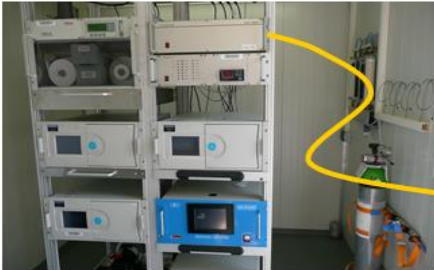
technische Ausrüstung im Container
