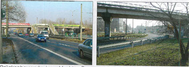
Brückenbauwerke im schlechten Bauzustand
